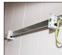
Rail de mise à la terre
