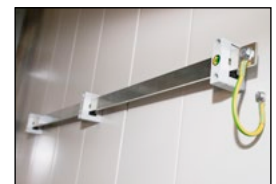
Rail de mise à la terre
