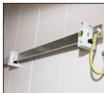
Rail de mise à la terre
