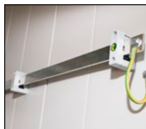
Rail de mise à la terre
