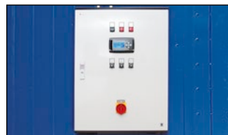
Armoire électrique pour un raccordement central
