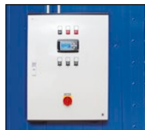
Armoire électrique pour un raccordement central
