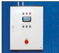
Armoire électrique pour un raccordement central
