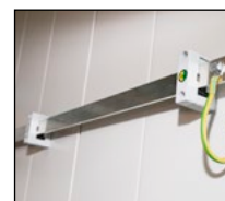
Rail de mise à la terre
