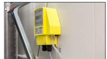
Surveillance de la sortie d'air pour un taux de renouvellement d'air de > 2,0/h
