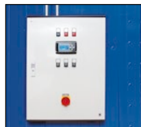
Armoire électrique pour un raccordement central
