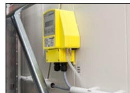
Surveillance de la sortie d'air pour un taux de renouvellement d'air de > 2,0/h
