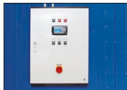
Armoire électrique pour un raccordement central
