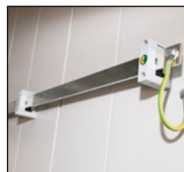
Rail de mise à la terre
