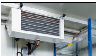
Climatisation pour une température précise à l'intérieur
