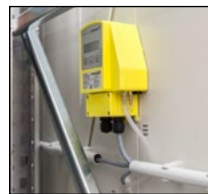
Surveillance de la sortie d'air pour un taux de renouvellement d'air de > 2,0/h
