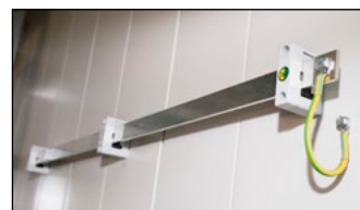
Rail de mise à la terre à l'intérieur du local
