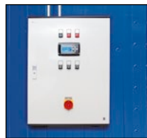
Armoire électrique pour un raccordement central
